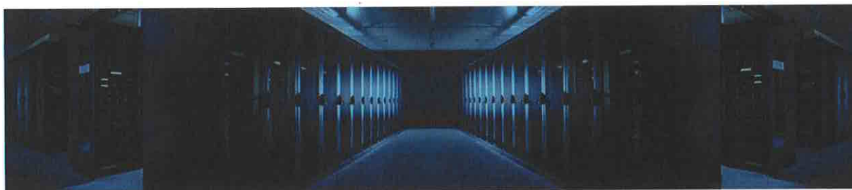
Figura 55 Sala técnica DataCenter
