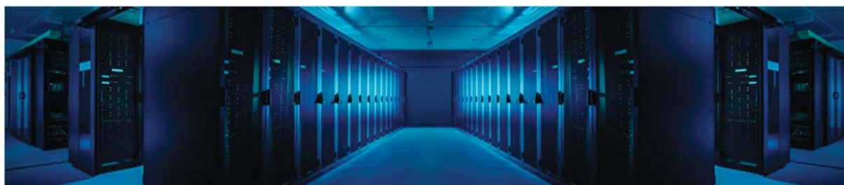
Figura 76 Sala técnica DataCenter
