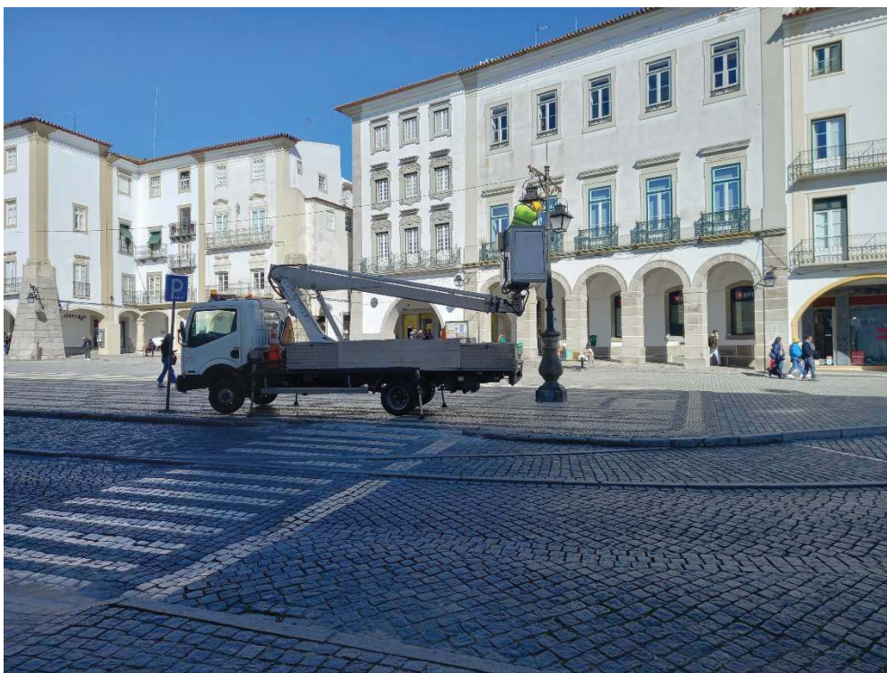
Figura 93 Alteração dos controladores das Luminárias
